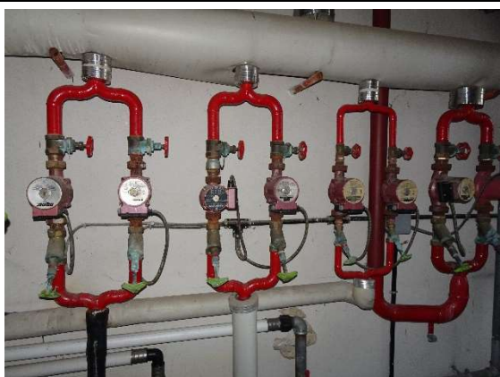
Distribuzione in sottocentrale
