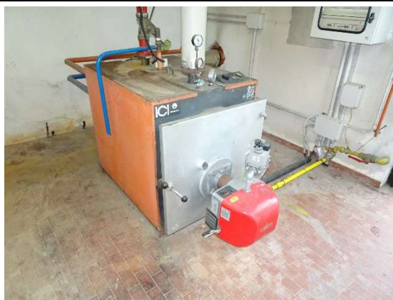
Vista generatore di calore
