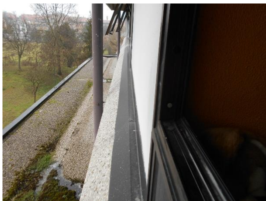
Aggetto tra i piani rialzato e primo sopra il rialzato lato ovest
